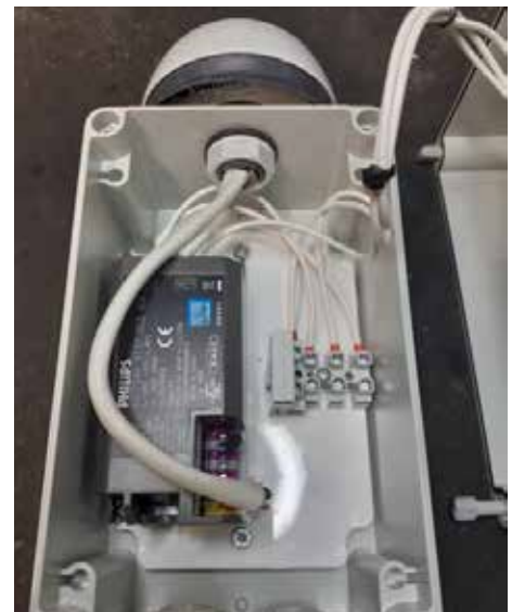
Figure 2 : intérieur du boîtier de commande avec le nœud de communication monté directement au dessus du boîtier (montage en extérieur seulement)
