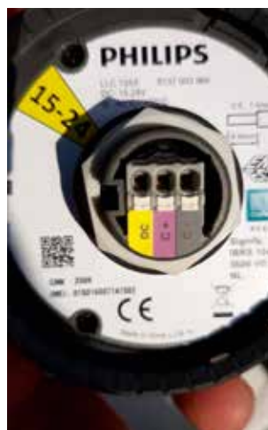
Figure 5 : raccordement du nœud de communication
